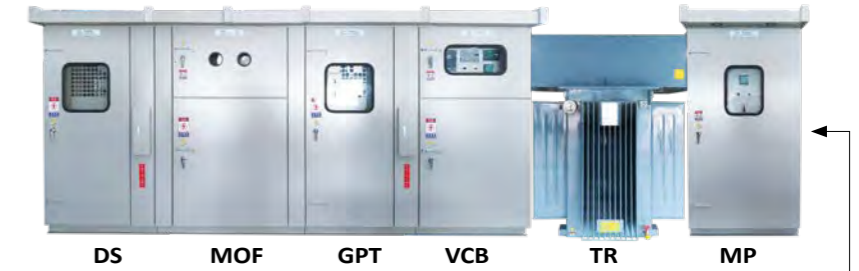
DS MOF GPT VCB TR MP
